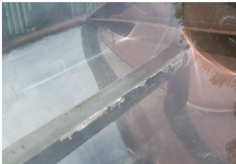
Figura 8 - Detalhe do foco solar no tubo trocador de calor
